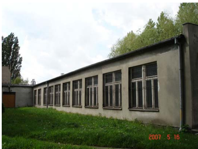
Elewacja boczna – podłużna – zarysowania i zawi
