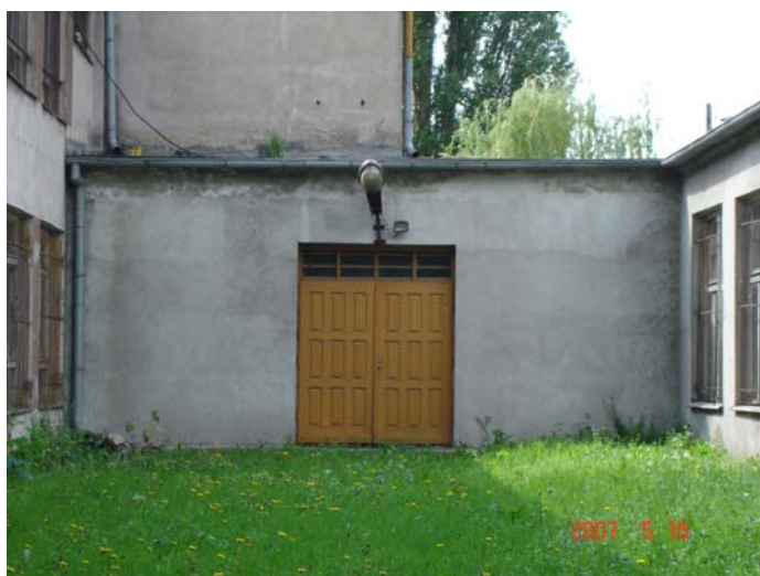
Elewacja frontowa – łącznik– zawilgocenie ściany
