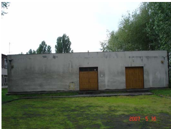
Elewacja frontowa - szczytowa – zarysowanie ściany w środkowej górnej części
