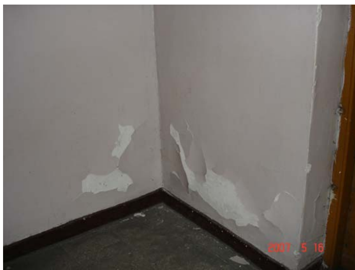
Zawilgocenie ściany wiatrołapu
