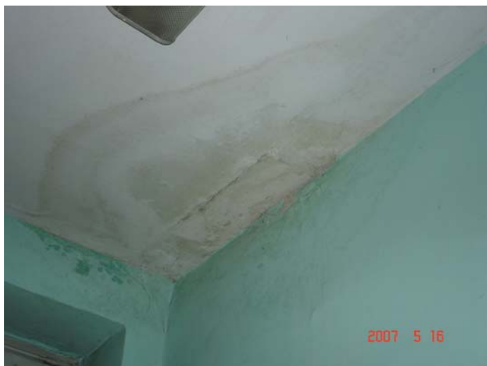
Zawilgocenie sufitu i ściany – przecieki z dachu
