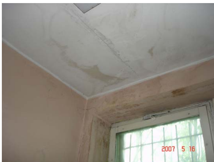
Zawilgocenie sufitu i ściany – przecieki z dachu
