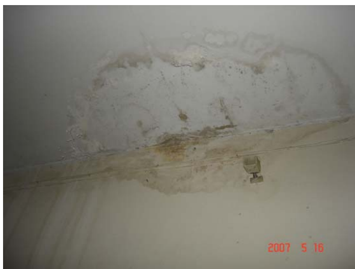
Zawilgocenie sufitu i ściany – przecieki
