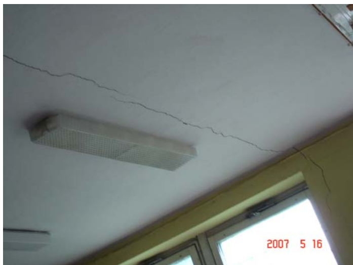
Zarysowanie sufitu i ściany
