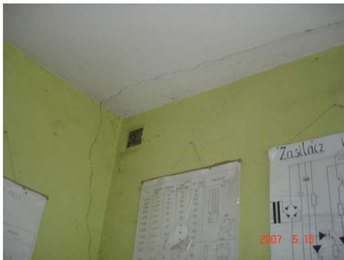
Zarysowanie ściany i sufitu
